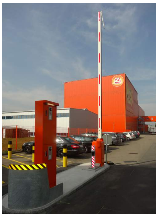
Mittels Schranken und Badge-System wird das Gelände vor unbefugtem Zutritt geschützt. Personen ohne Zutritts-Badge, oder in einem dem System unbekanntem Fahrzeug, erhalten Zutritt nach einer Anmeldung über eine Gegensprechanlage.
