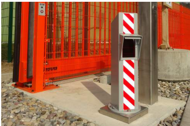
Die Nummernschilder von ankommenden Motorfahrzeugen werden automatisch gescannt. Für Nummern, die in einer Datenbank hinterlegt sind, öffnet sich die Schranke automatisch.
