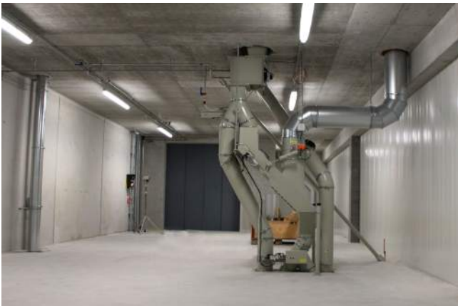
Effiziente Getreidereinigungs- und Förderanlagen.
