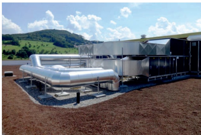
Hohe Anforderungen an die Luftqualität: Lüftungsmonoblock
