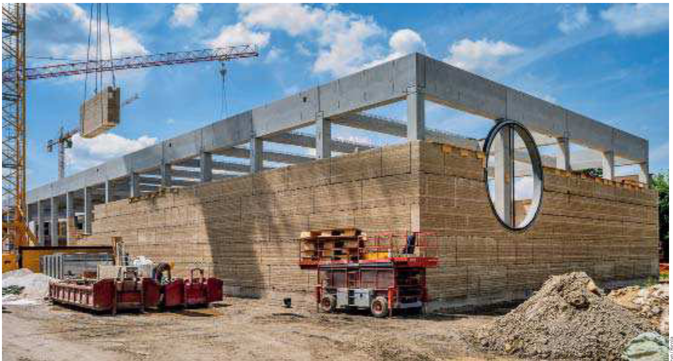
Der Bau mit den vorfabrizierten 660 «Stampflehm-Elementen», gewonnen aus der Umgebung, kostete 16 Millionen Franken.
